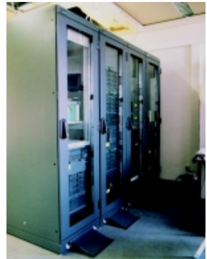
EDV-Anlage beim EBZI (Server für zentrale Anwendungen)
